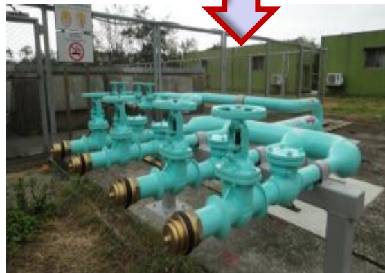
進入緊急循環 水系統閥門
