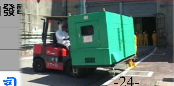
480V 移動式柴油發電機
