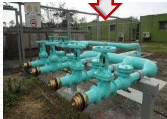
進入緊急循環 水系統閘門
